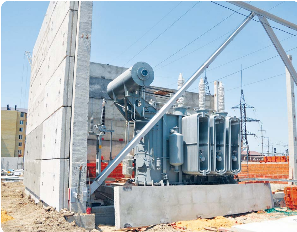
Шумозащитное ограждение вокруг силового трансформатора мощностью 25 МВА
